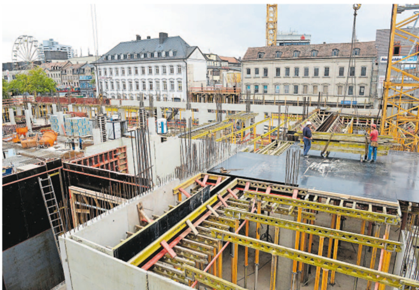
Das Erdgeschoss nimmt zusehends Gestalt an: Auch während des Kirchweihbetriebs (links hinten im Bild das Riesenrad) soll es auf der Großbaustelle Fortschritte geben. Foto: Hans-Joachim Winckler
