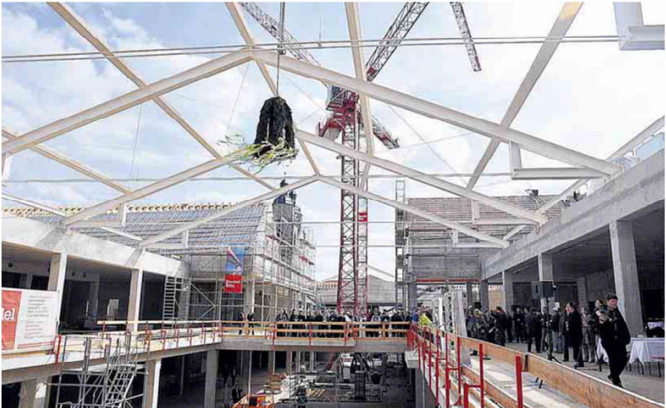
Richtfest! Im Oktober will das neue Einkaufszentrum „Arsenal“ auf dem Wittenberger Arsenalplatz seine Tore öffnen.
